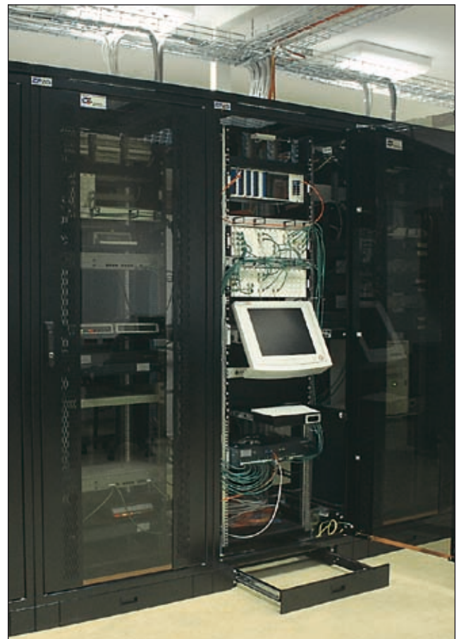
Серверное помещение смонтировано на базе шкафов производства ZPAS. Монтажные работы выполнило торгово-информационное предприятие ООО „MCP” из Кракова ( www.mcp.pl ).
