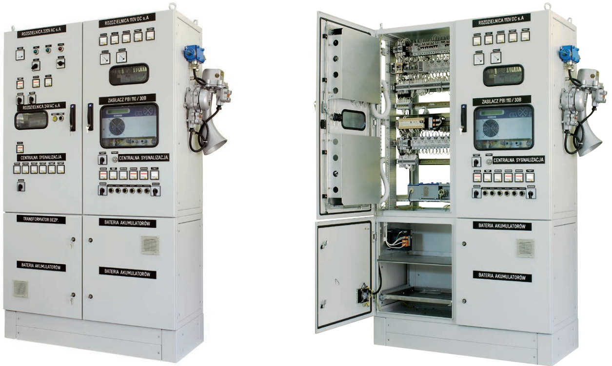
Schaltanlage 220/110/24 V für Bergwerkbetriebe
