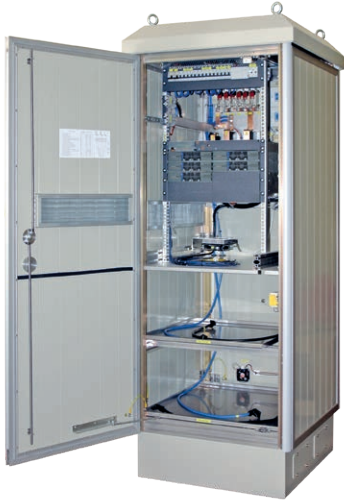
Outdoorschrank für die Telekommunikation
