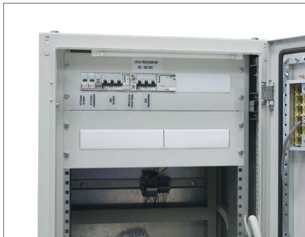
Relaisgestütztes AST-System, montiert im Schrank
