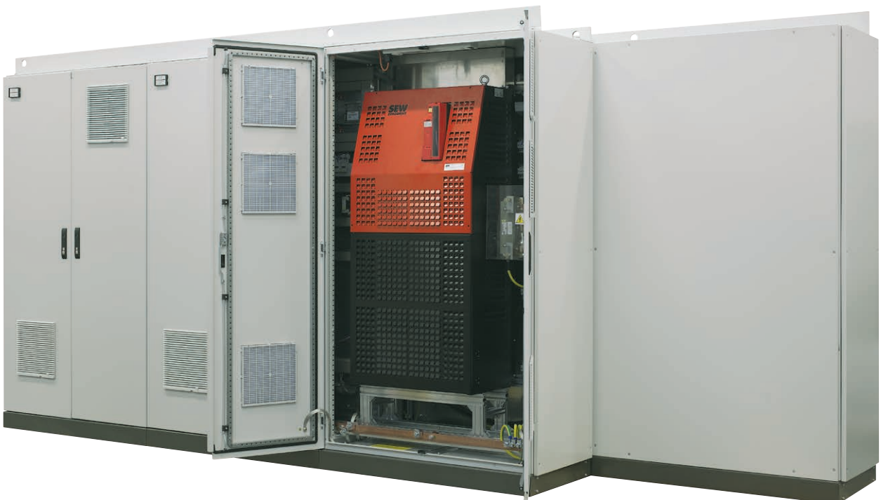
Steuerschränke für eine industrielle Keramikfabrik
