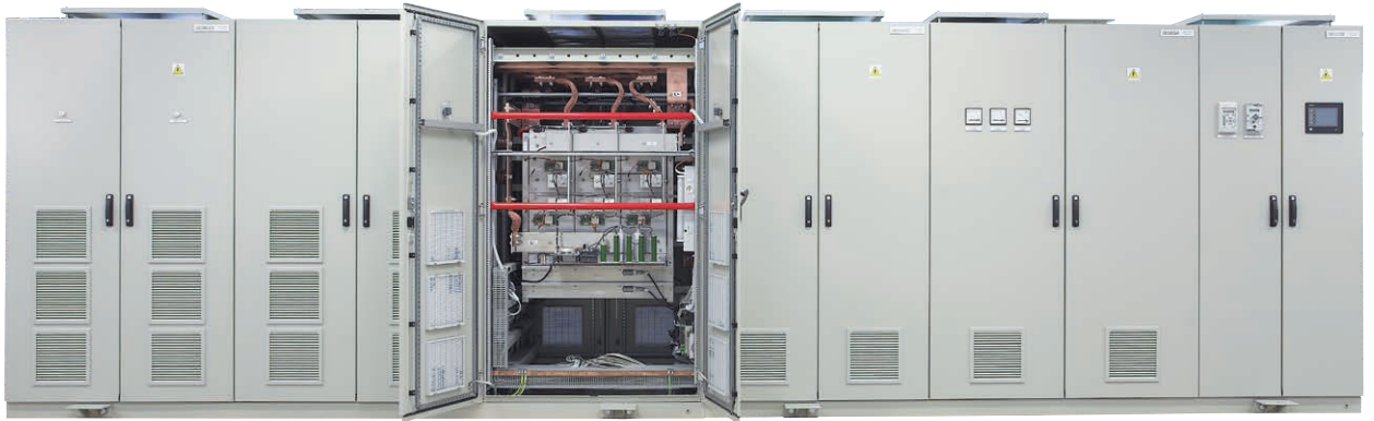
Erregersystem für einen 600 MW Generator
