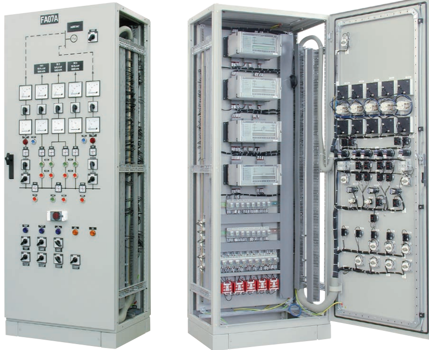
AST-System für mehrere Zuleitungen auf Basis der Steuerpanels der Fa. Energotest-Energopomiar, realisiert für die Energiestation Wielopole
