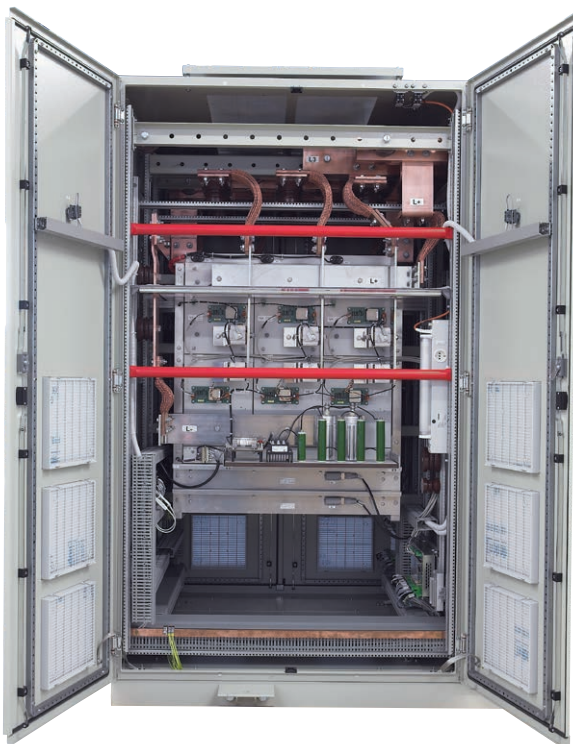
Erregersystem für einen 600 MW Generator - Gleichrichterfeld
