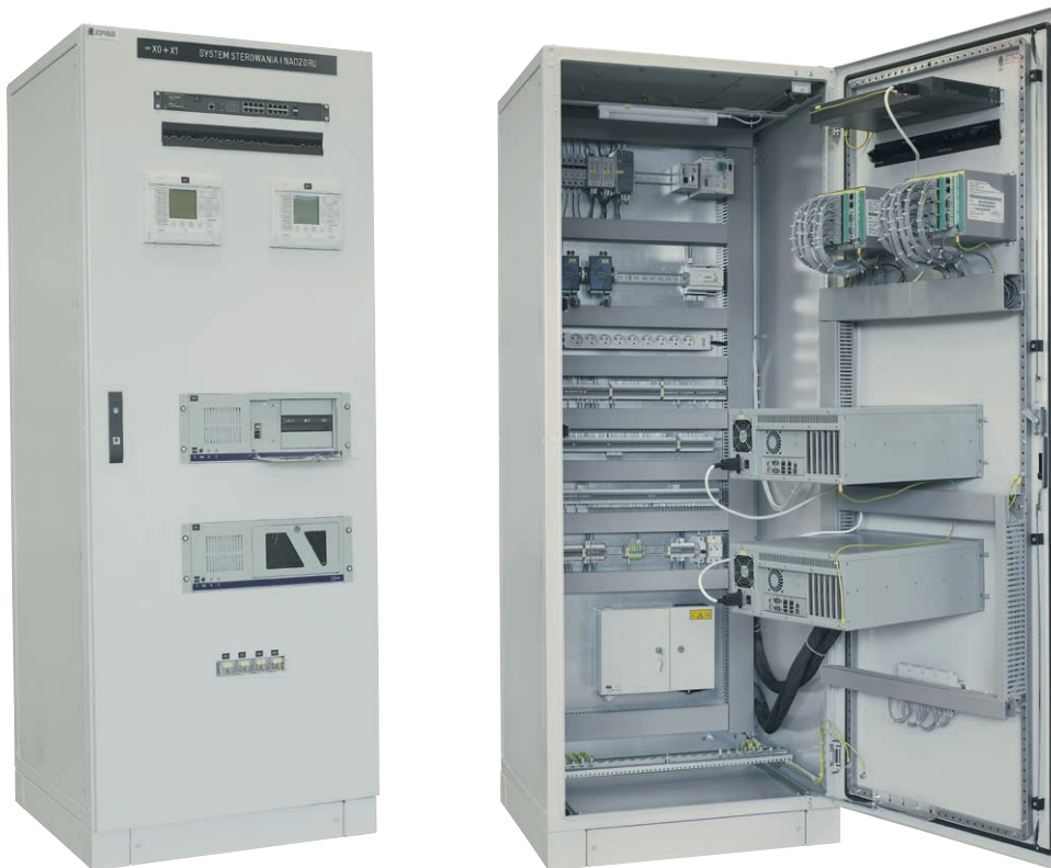
Schrank mit Steuersystem und Überwachung mit an der Tür installierten Rechnern
