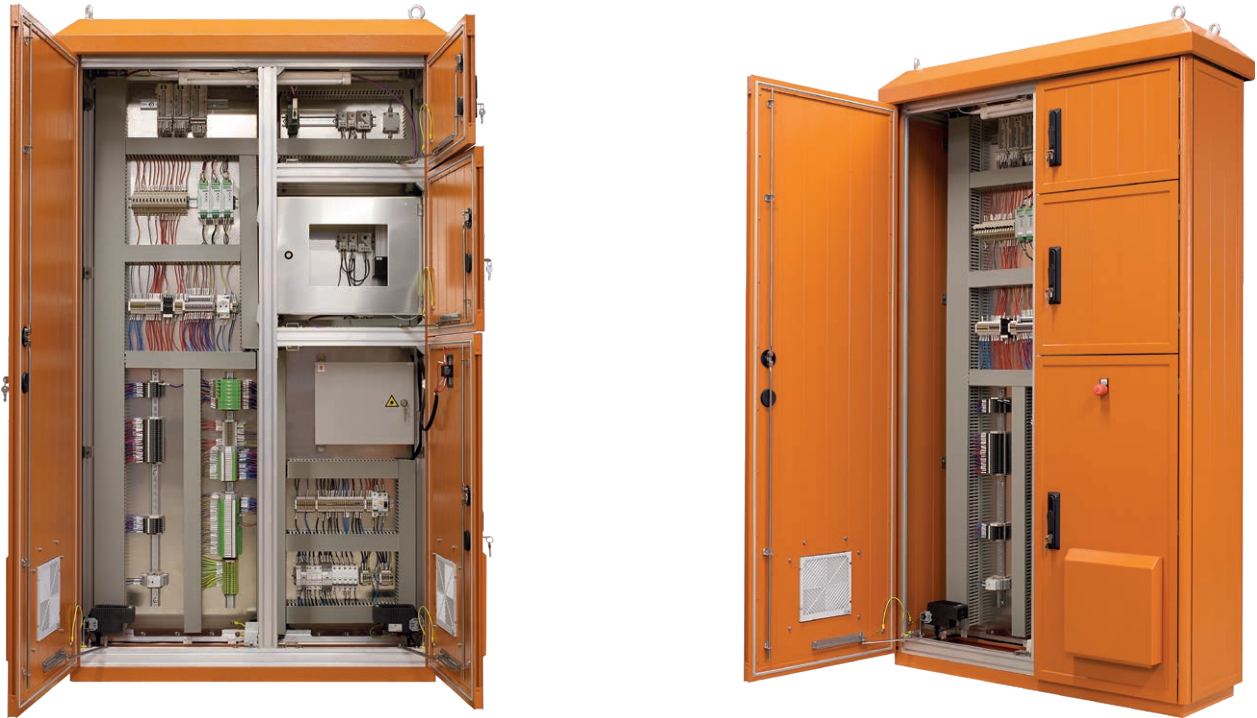
Der Schaltschrank basiert auf einem SZD-Outdoor-Gehäuse (siehe Produktkatalog der ZPAS-Gruppe 2019, Seite 238), und dient als Objektstation eines verteilten Kesselsteuerungssystems
