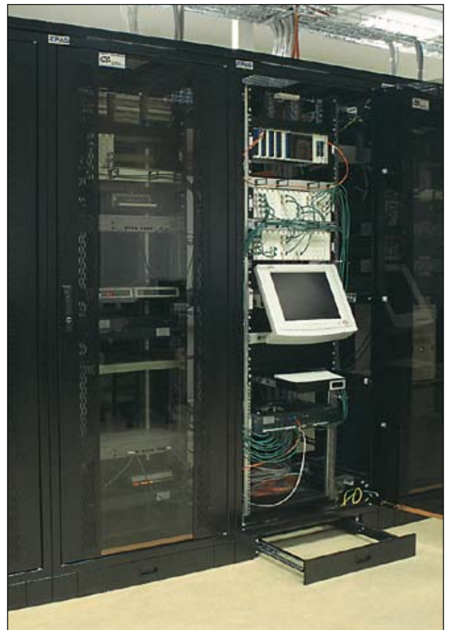
Serwerownia wykonana na bazie szaf SZB SE. Instalację przeprowadziło Przedsiębiorstwo Handlowo-Informatyczne „MCP” Sp. z o.o. z Krakowa ( www.mcp.pl ).
