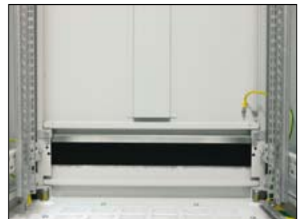
Maskownica 3 U zamontowana w szafie o szerokości 600 mm
