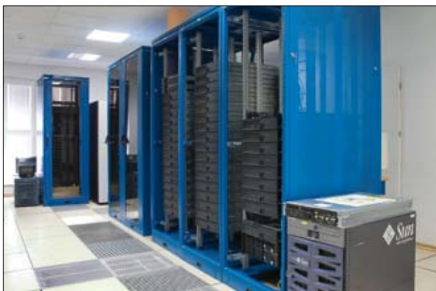
Szafy SZB SE w serwerowni Politechniki Wrocławskiej
