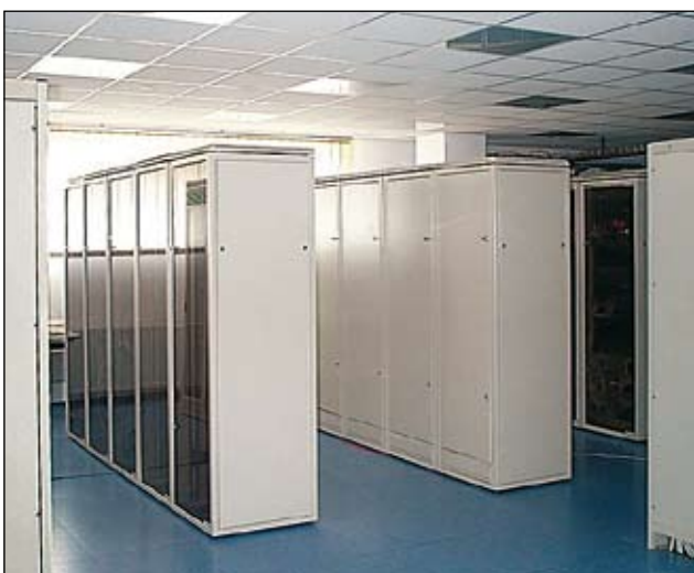
Szafy SZB zainstalowane w siedzibie BPT „TELBANK” S.A. w Warszawie
