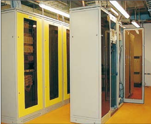
Główny punkt dystrybucyjny w budynku Giełdy Papierów Wartościowych w Warszawie. Instalacja na bazie szaf SZB przeprowadzona przez firmę ALMA z Poznania ( www.ama.biz.pl ).
