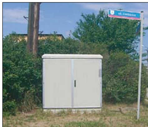
Szafa przed rozbudową
