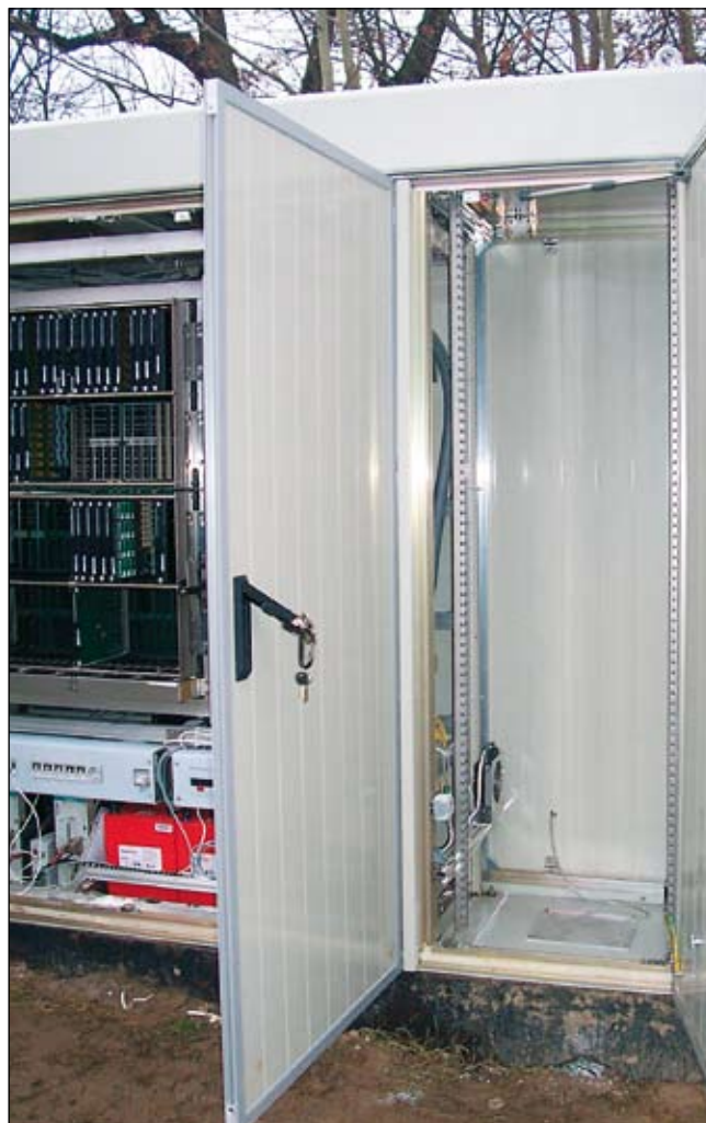
Szafa po rozbudowie
