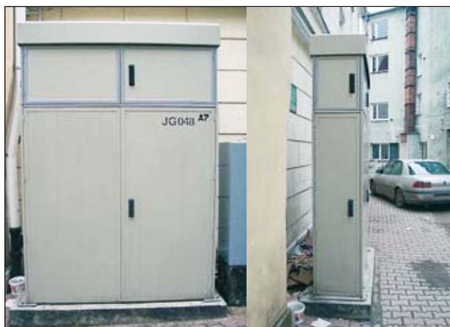
Szafa po rozbudowie
