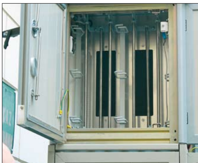
Szafa po rozbudowie
