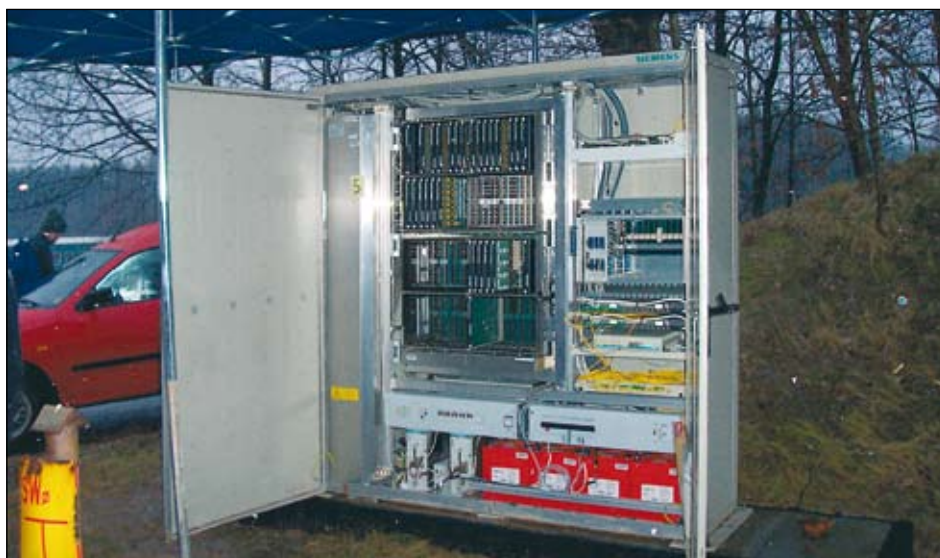
Szafa przed rozbudową
