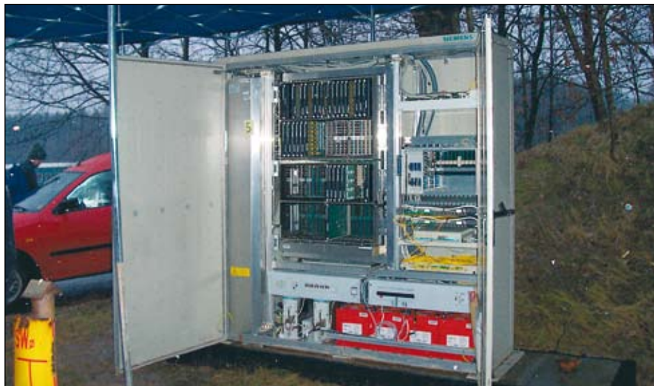
Szafa przed rozbudową
