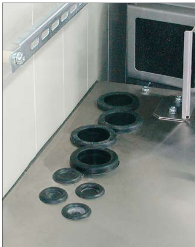
Przepust wykonany z dławików gumowych
