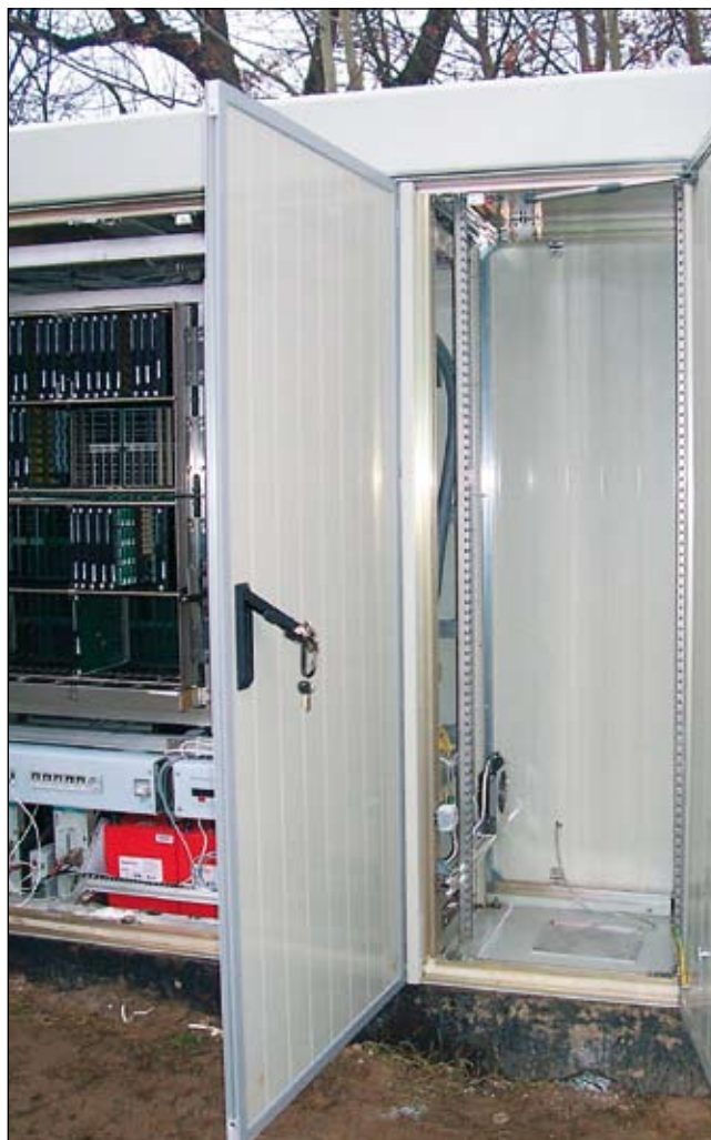
Szafa po rozbudowie
