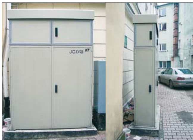
Szafa po rozbudowie
