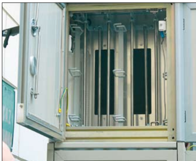
Szafa po rozbudowie
