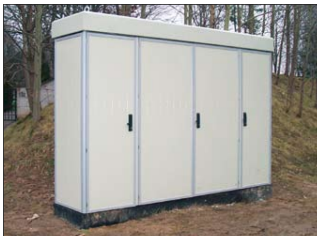
Szafa po rozbudowie
