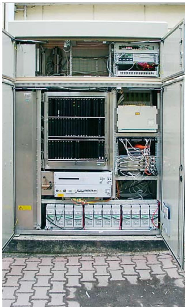
Szafa po rozbudowie
