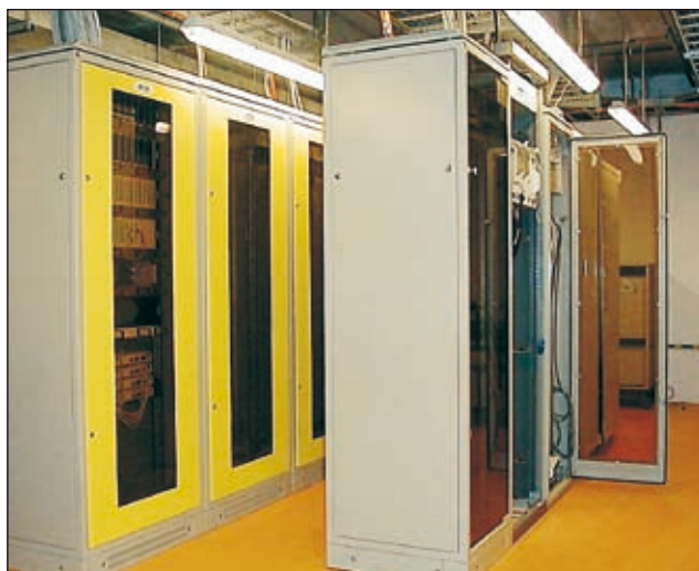
Główny punkt dystrybucyjny w budynku Giełdy Papierów Wartościowych w Warszawie. Instalacja na bazie szaf SZB przeprowadzona przez firmę ALMA z Poznania ( www.alma.biz.pl ).
