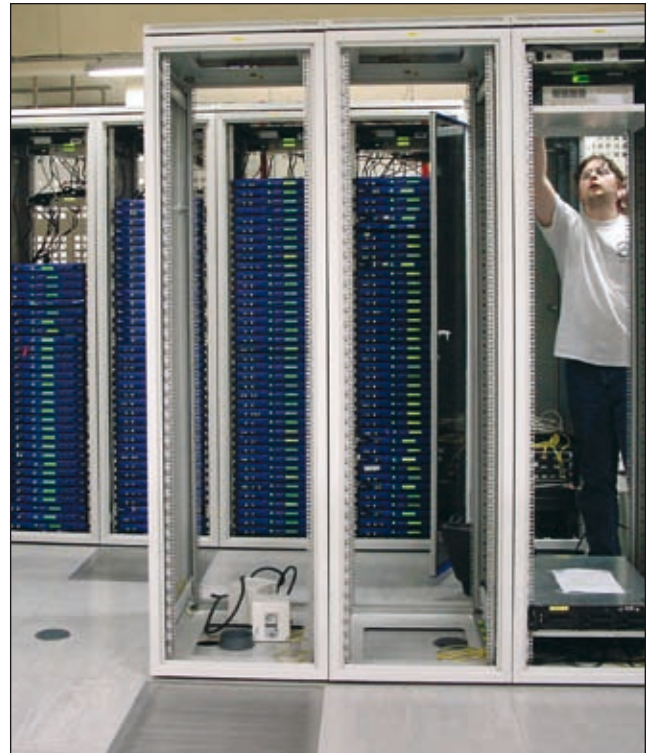
Montaż serwerów do szaf SZB w serwerowni internetowej firmy OVH w Paryżu
