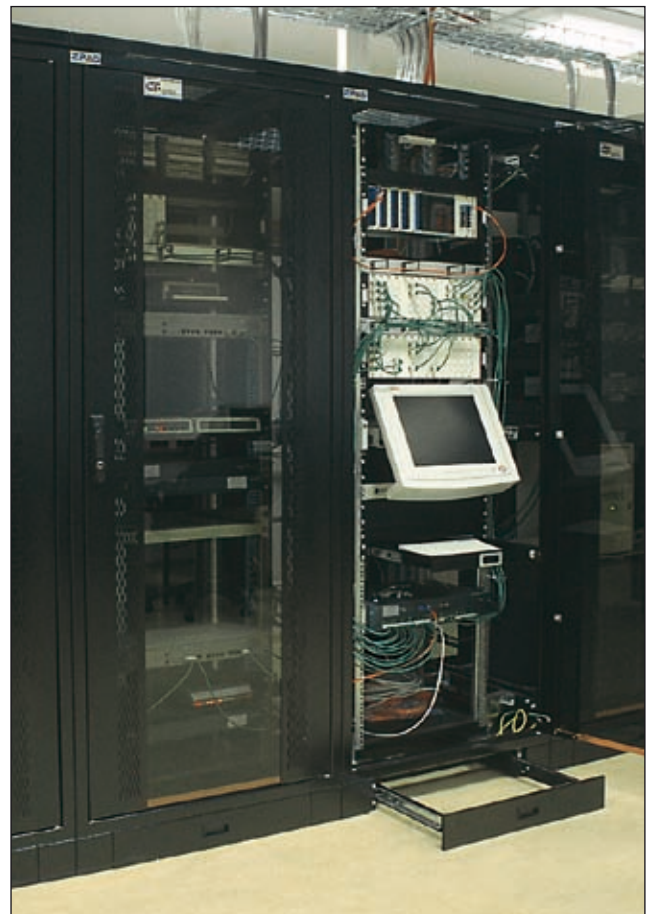
Serwerownia wykonana na bazie szaf SZB SE. Instalację przeprowadziło Przedsiębiorstwo Handlowo-Informatyczne „MCP” Sp. z o.o. z Krakowa ( www.mcp.pl ).
