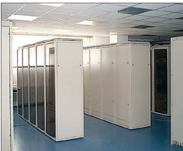
SZB-Schränke, installiert im Gebäude der BPT „TEL BANK“ S.A. in Warszawa
