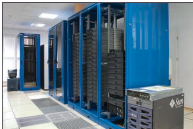
Schränke SZB SE im Serverraum der Technischer Fachhochschule Wrocław
