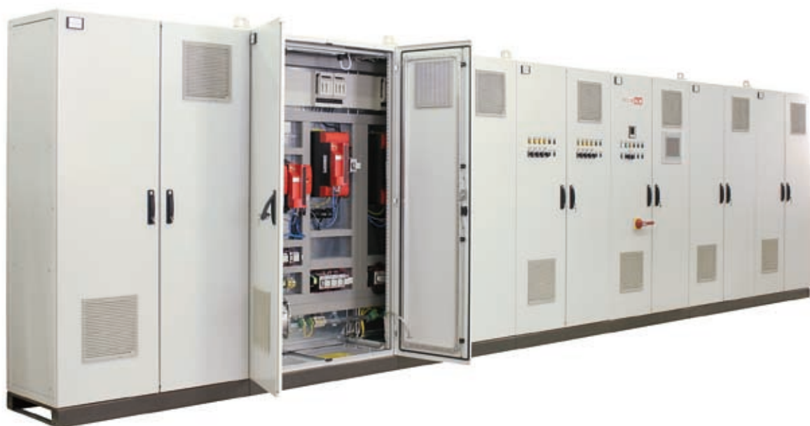
Ensemble d'armoires de commande et d'alimentation pour établissements de production céramique
