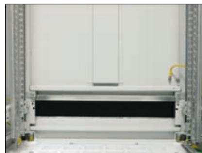
Un cache-panneau 3 U installé dans la baie de 600 mm de large
