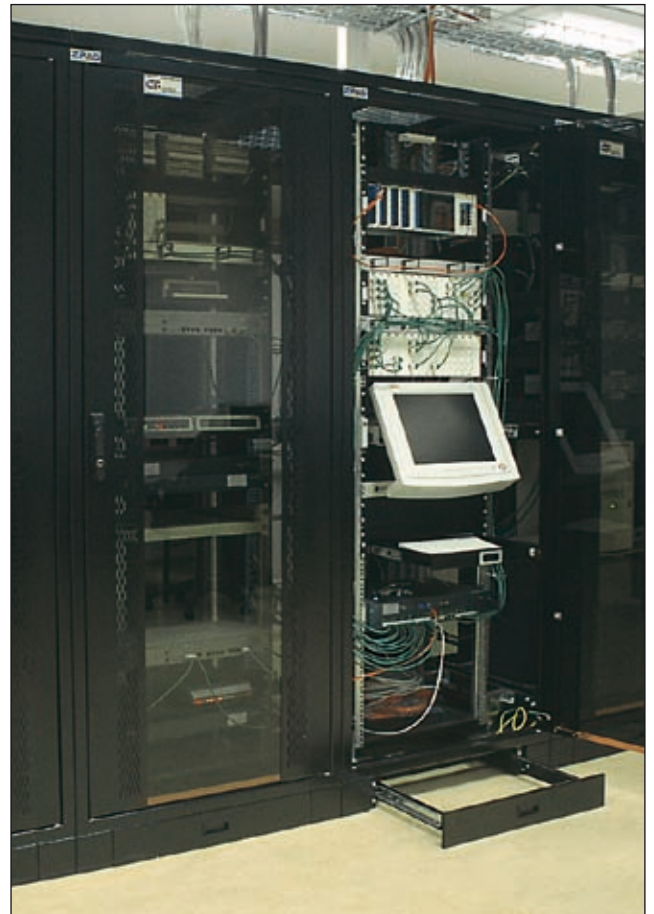
Salle des serveurs effectuée sur la base des baies SZB SE. L'installation faite par l'Entreprise Commerciale et Informatique MCP Sp. z o.o. de Cracovie ( www.mcp.pl ).
