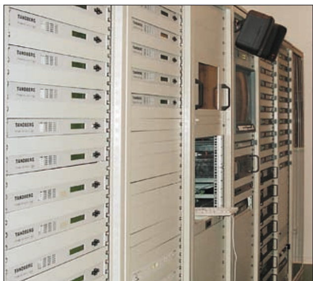
Centre tête de ligne dans le Département de Telekomunikacja Polska-Zachód Sp. z o.o. (Télécommunication Polonaise-Ouest) à Stargard Szczecinski. L'installation basée sur les baies SZB a été réalisée par l'entreprise VECTOR SARL à Gdynia ( www.vector.com.pl ).
