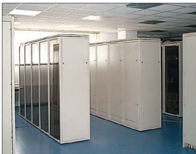
Baies SZB installées dans le siège de BPT « Telbank » SA à Varsovie.
