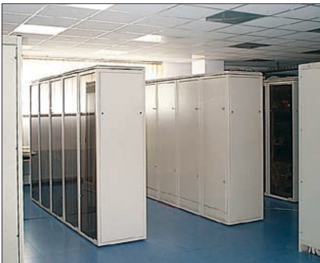
Шкафы SZB установлены в офисе BPT„TELBANK” S.A. в Варшаве.
