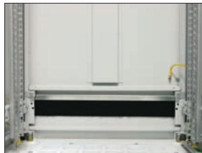
Панель 3 U установлена в шкафу шириной 600 мм
