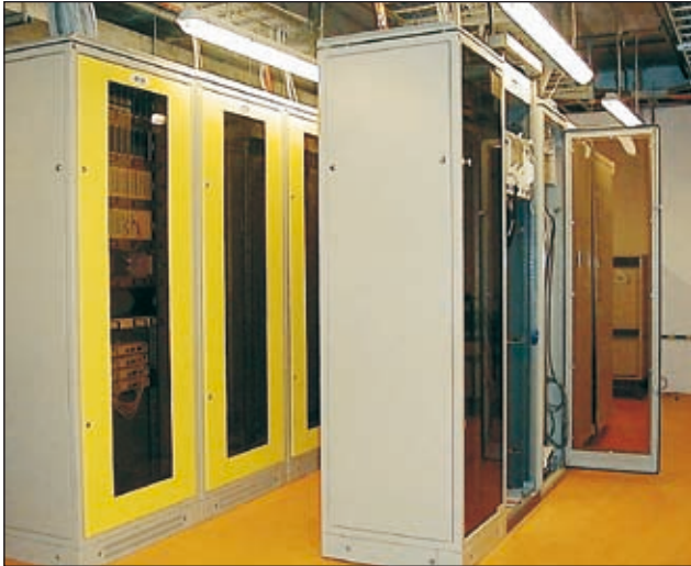
Главный распределительный узел в здании Варшавской фондовой Биржи. Инсталляция на базе шкафов SZB проведена фирмой ALMA из Познани ( www.alma.biz.pl ).
