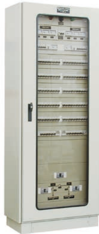
Двухсекционный шкаф с модульной аппаратурой
