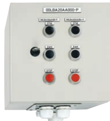
Щит управления для электростанции Бельхатов, изготовлен на базе шкафа SWN
