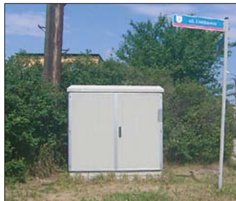
Szafa przed rozbudową
