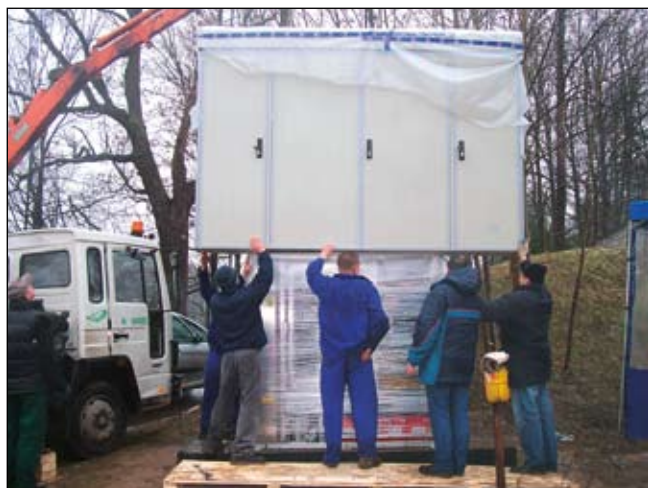
Szafa w trakcie rozbudowy
