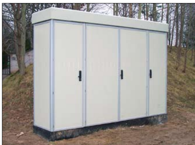
Szafa po rozbudowie
