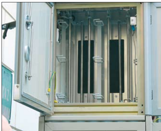
Шкаф после реконструкции
