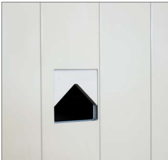
Кабельный ввод в дверях – вид с наружной стороны шкафа
