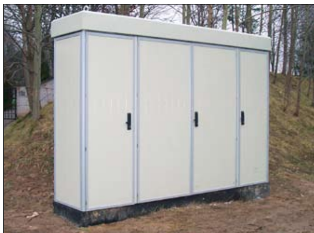
Шкаф после реконструкции
