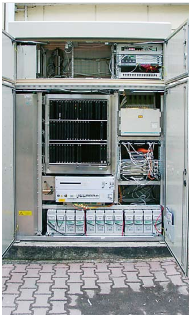
Шкаф после реконструкции
