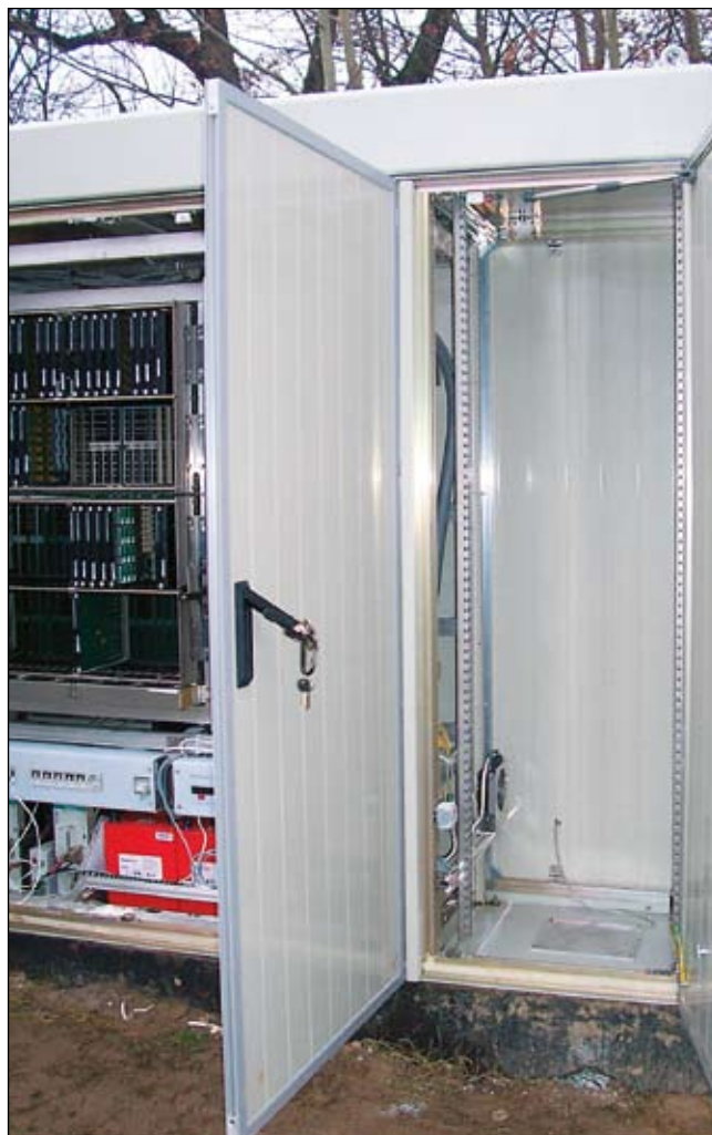
Шкаф после реконструкции
