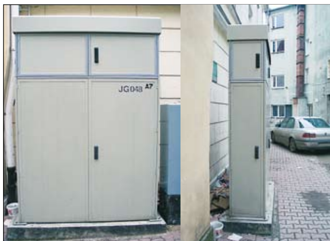
Шкаф после реконструкции
